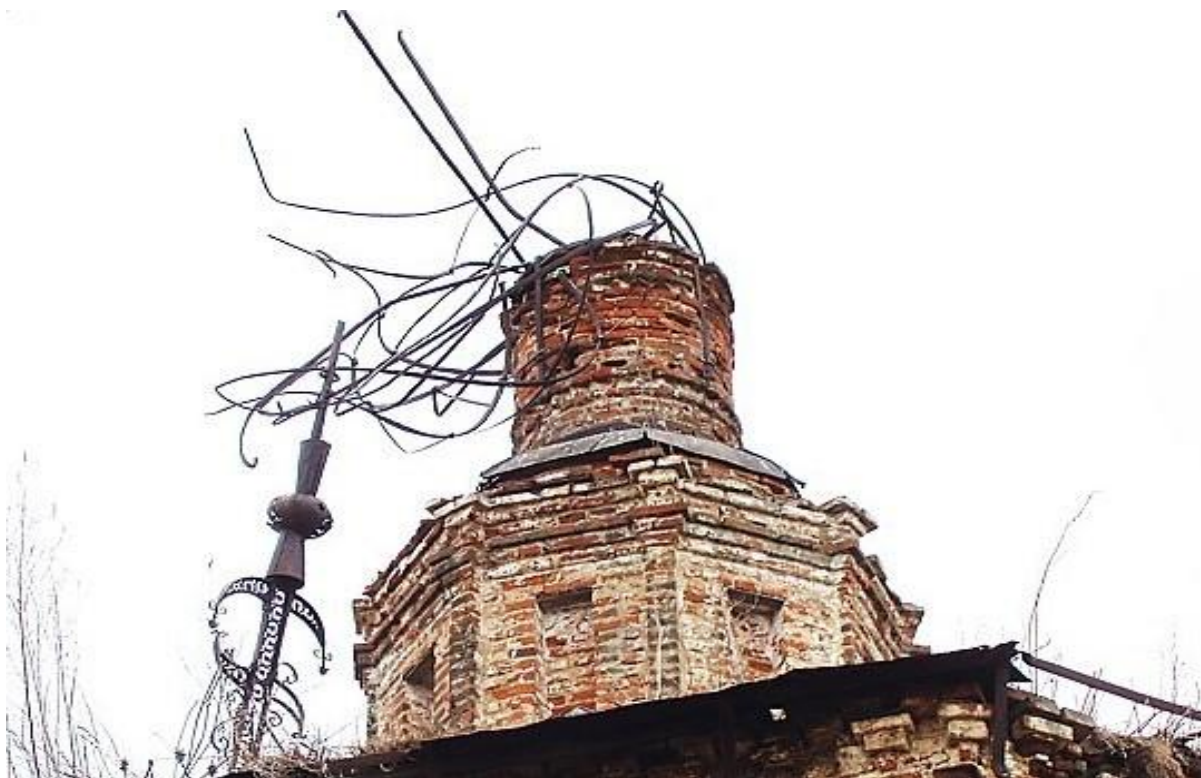
Фото 1. Состояние креста надглавного и купола храма Архангела Михаила до реставрации Фото из архива авторов (2013 г.)
